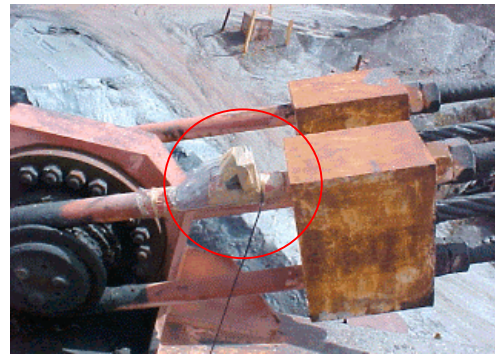
Sensor colocado em um tirante
